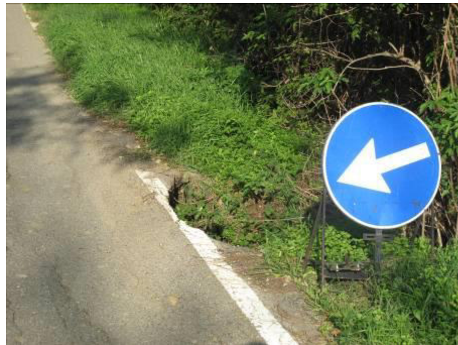
Punto di osservazione 2 - segni di erosione nella strada
